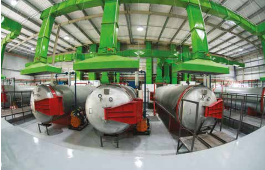
Estructura interna de la planta de generación termoeléctrica a partir del biogás de relleno
