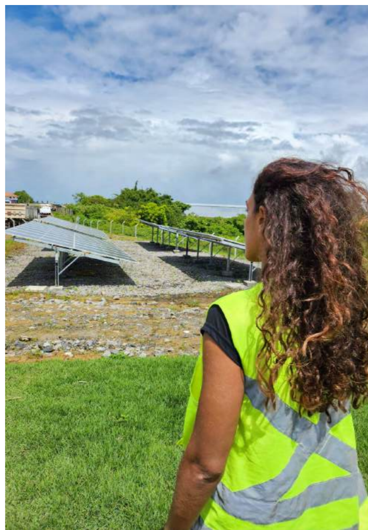
Painéis de Energia Solar - UVS Águas Claras Ambiental - BA
