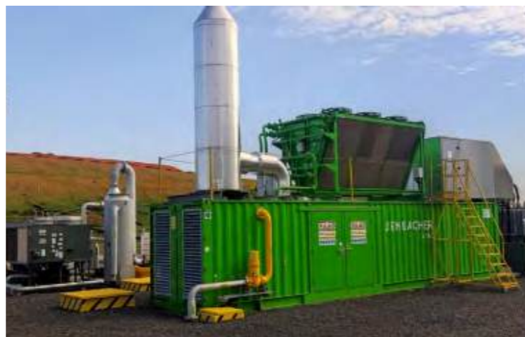
Termoelétrica inaugurada em 2023 - UVS Termoverde Quatá - SP
