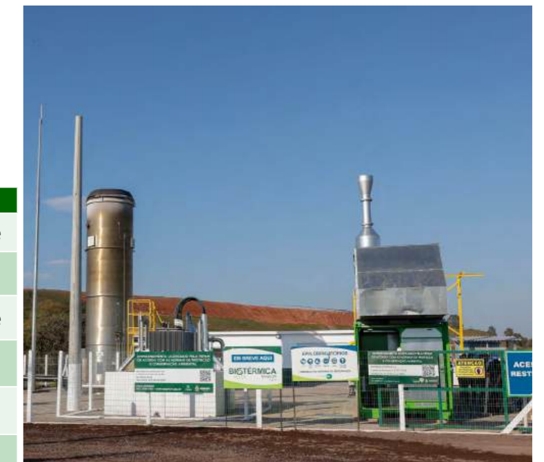
Usina Termoeletrica - UVS Biotermica - Minas do Leão - RS
